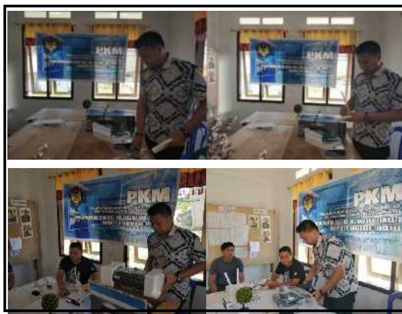
Gambar 2. Perakitan Jaringan LAN dan Instalasi Printer Jaringan
