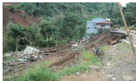
Gambar 3. Foto Kejadian Longsor Rumah Makan dan Rumah Penduduk
