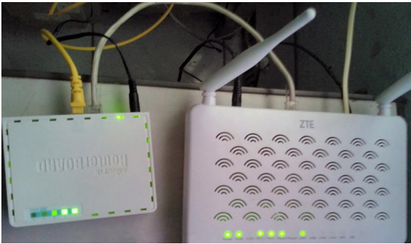
Gambar 14 Menghubungkan Modem dan Router Mikrotik
